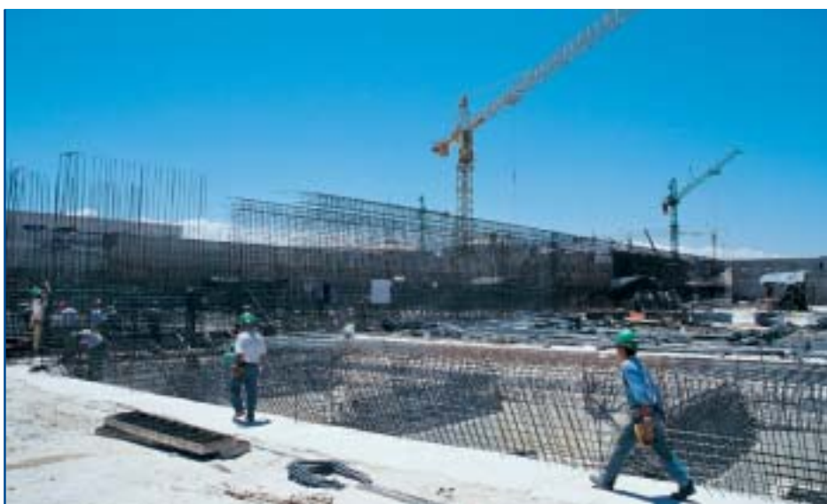
Aplicação de vergalhões na planta de tratamento de água La Farfana (Chile)
