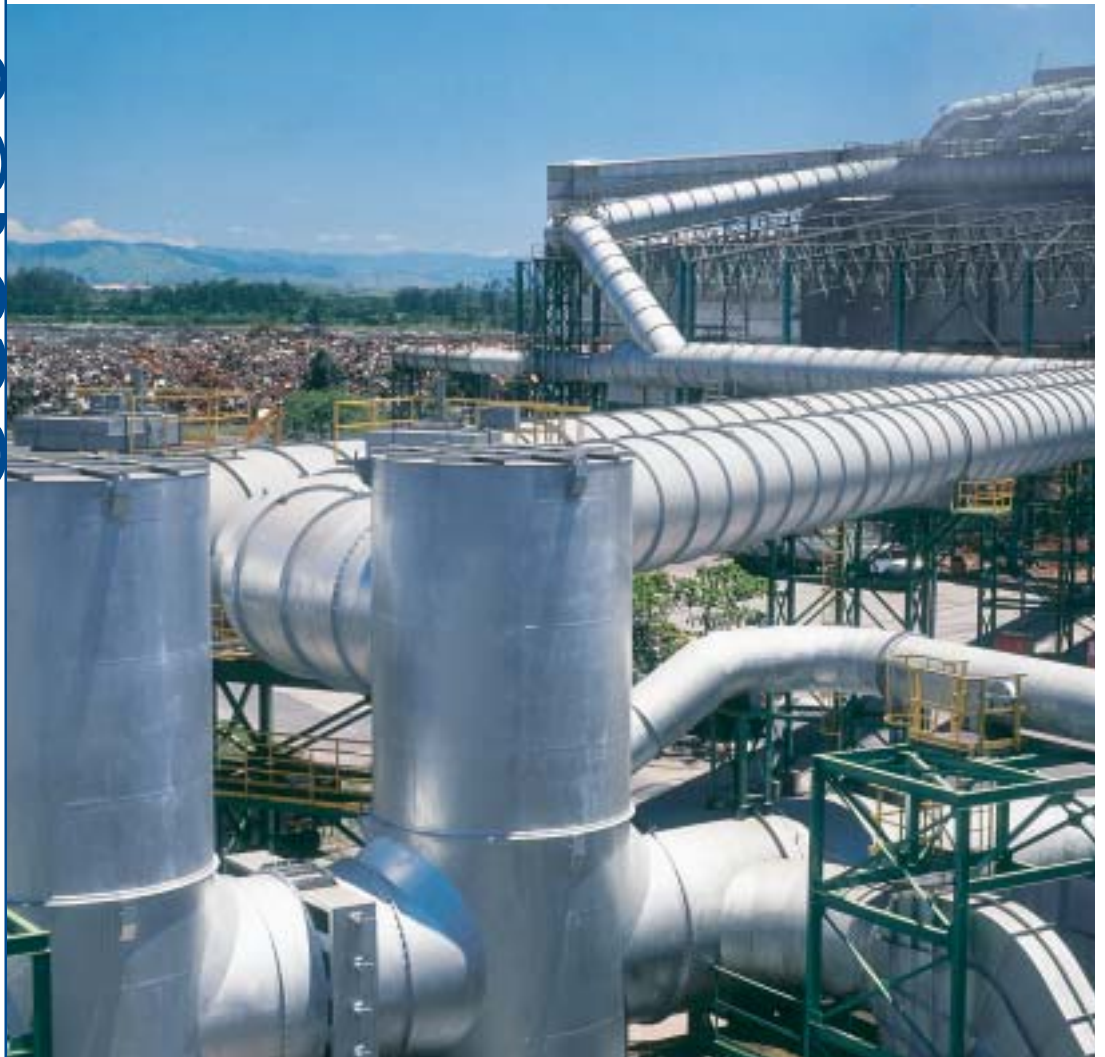
Sistema de Despoeiramento da Gerdau Cosigua (RJ)
