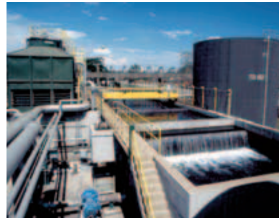
SISTEMAS PARA TRATAMENTO E RECIRCULAÇÃO DAS ÁGUAS INDUSTRIAIS ESTÃO PRESENTES EM TODAS AS USINAS SIDERÚRGICAS GERDAU
