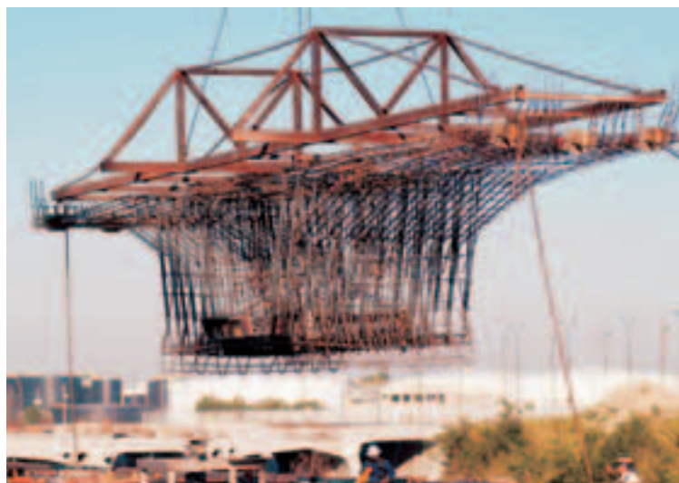
CONSTRUÇÃO DA AUTO- ESTRADA LEE ROY SELMAN EXPRESSWAY, EM TAMPA, NA FLÓRIDA, UTILIZA AÇO GERDAU
