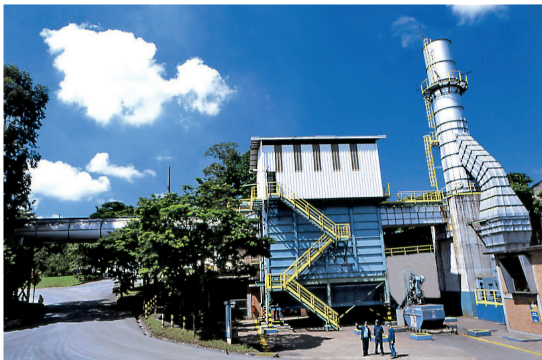
SISTEMA DE DESPOEIRAMENTO: TECNOLOGIA GARANTE A PROTEÇÃO DO AR
